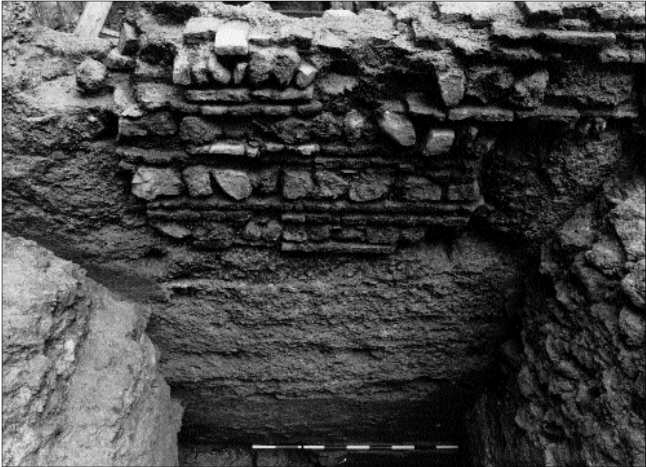
Detalle del alzado exterior de la muralla en el interior de la Torre 2. En primer término una separación a base de mampostería e hiladas alternas de ladrillo.
