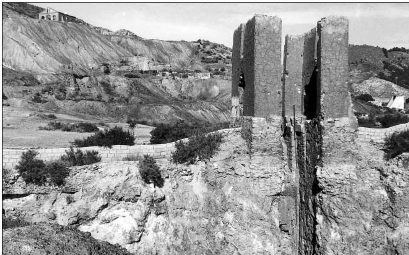
Foto 10.- Castillete de mampostería San Carlos. Se puede observar la sección del pozo al haberse desprendido uno de sus laterales.
